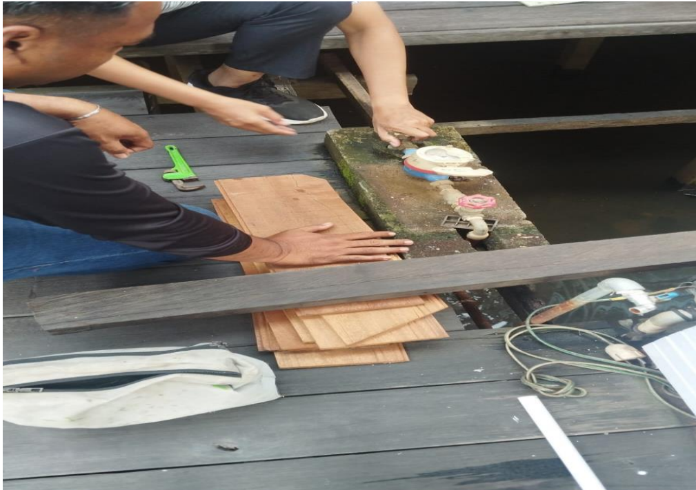
Pengecekan Pipa Bocor
